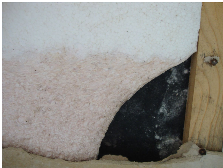
Abb. 5: Zerstörung der Polystyrol-Dämmung durch Leichtöl (© Blei-Institut)
