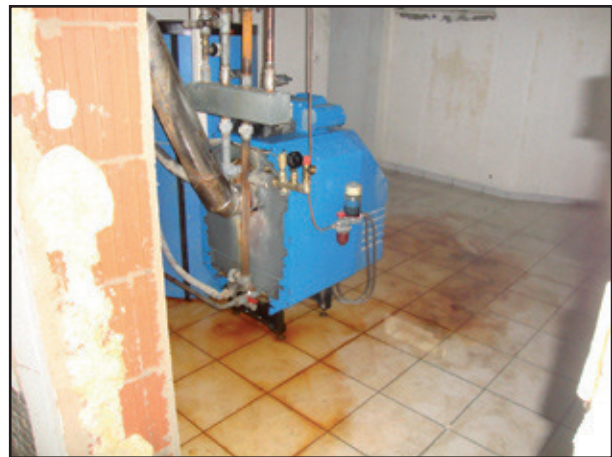
Abb. 1: Überschwemmungsschaden der Ölheizung (Quelle: Privatinstitut für Innenraumtoxikologie – Dr. Blei GmbH)
